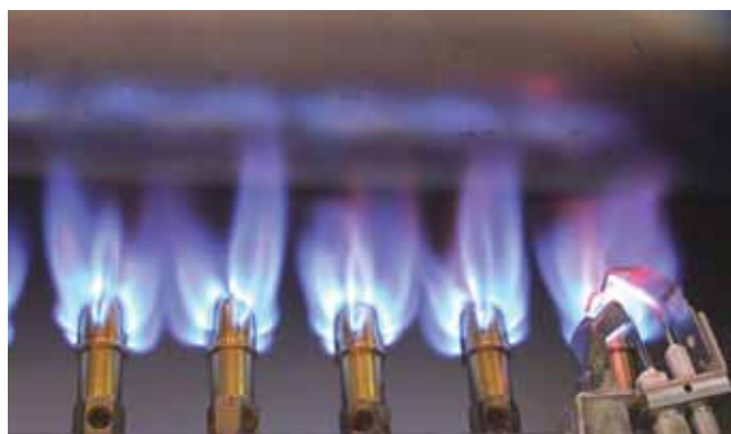
Figure 1 : Exemple de combustion complète : flammes bleues vives parsemées de flammes pourpres. Combustion inodore et propre, produisant du CO 2 et de la vapeur d'eau.
